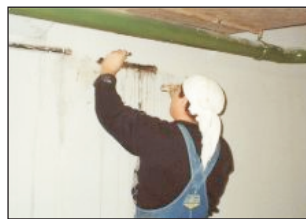
Вскрытие места скрытой протечки
